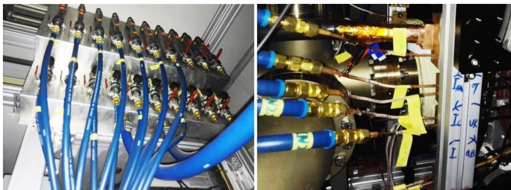
图 6.33 水冷系统中分水板与线圈连接实物图
